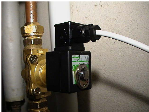
Bilde 4: Magnetventiler monteres på vanninntaket. Styringsenheten kontrollerer jevnlig at magnetventilene fungerer.
