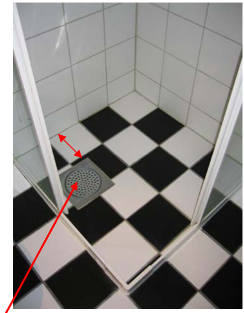
Bilde 8: Ved fornying og utbedring av eksisterende våtrom er ofte slukplasseringen gitt. Både avrenning og fall må tilpasses de lokale forholdene.
