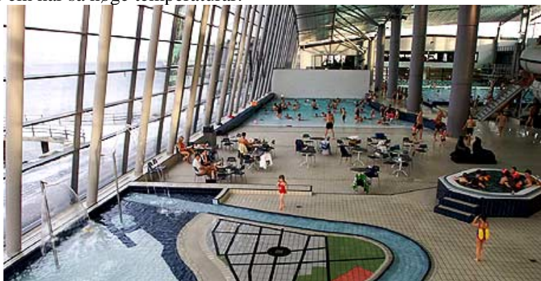
I Pirbadet blei det rust på opphengsbøylene til dei lyddempande platene i taket.(Foto: Scanpix/Gorm Kallestad)
